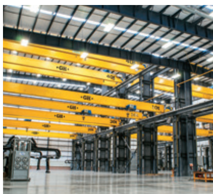
Однобалочный кран на опорах
