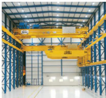
Grúa apoyada birraíl y grúa ménsula
