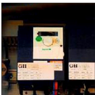
12 Variador frecuencia traslación puente
